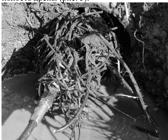
Рис. 5. Засорение дренажной трубы корневыми тканями
