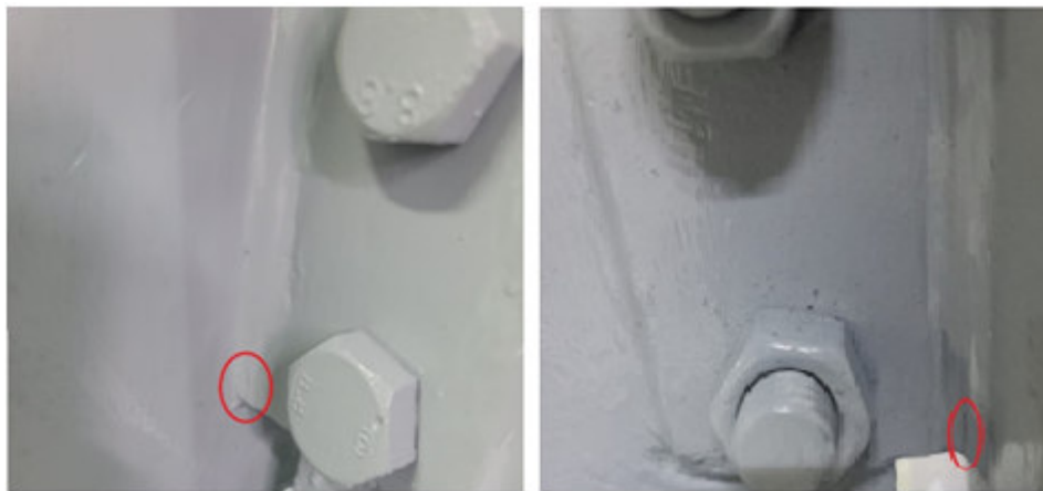
Рис. 5. Разрушения на образце с катетом швам 8 мм
