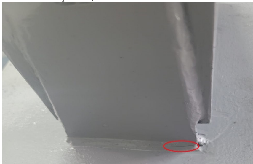
Рис. 7. Разрушения на образце с катетом шва 8 мм
