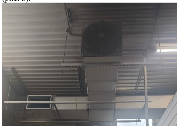
Рис. 1. Приточно-вытяжная вентиляция всего помещения цеха
