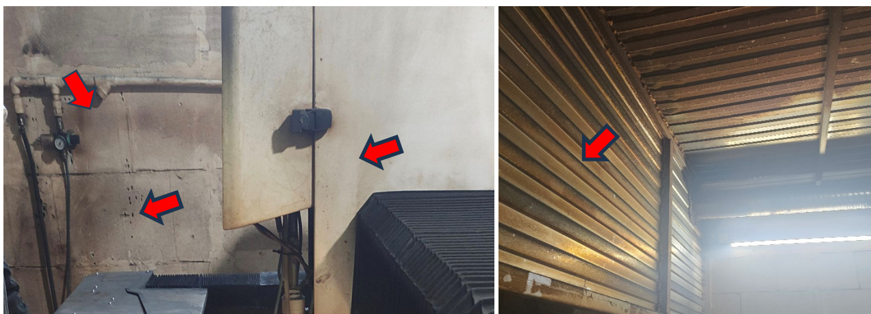
Рис. 4. Отложения на строительных конструкциях и оборудовании
