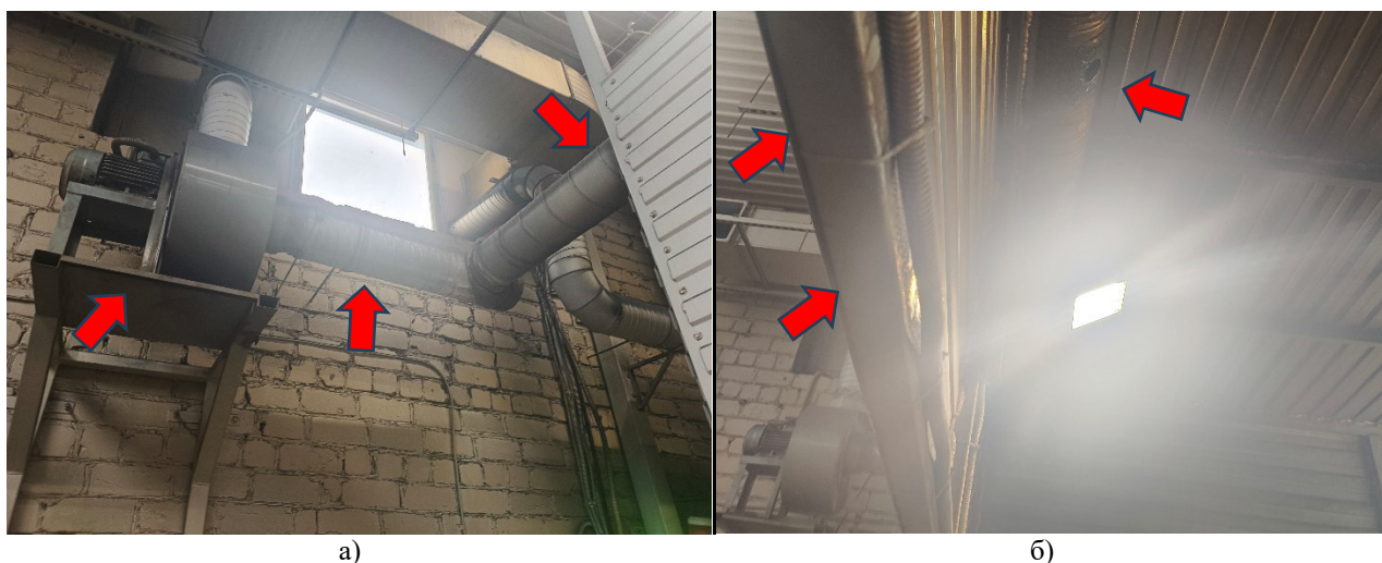
Рис. 3. Дополнительная местная вентиляция станка лазерной резки (а) вытяжной агрегат и система вентиляционных труб; (б) самодельное сопло, располагаемое в вентиляционной трубе и самодельный купол параллелепипедальной формы
