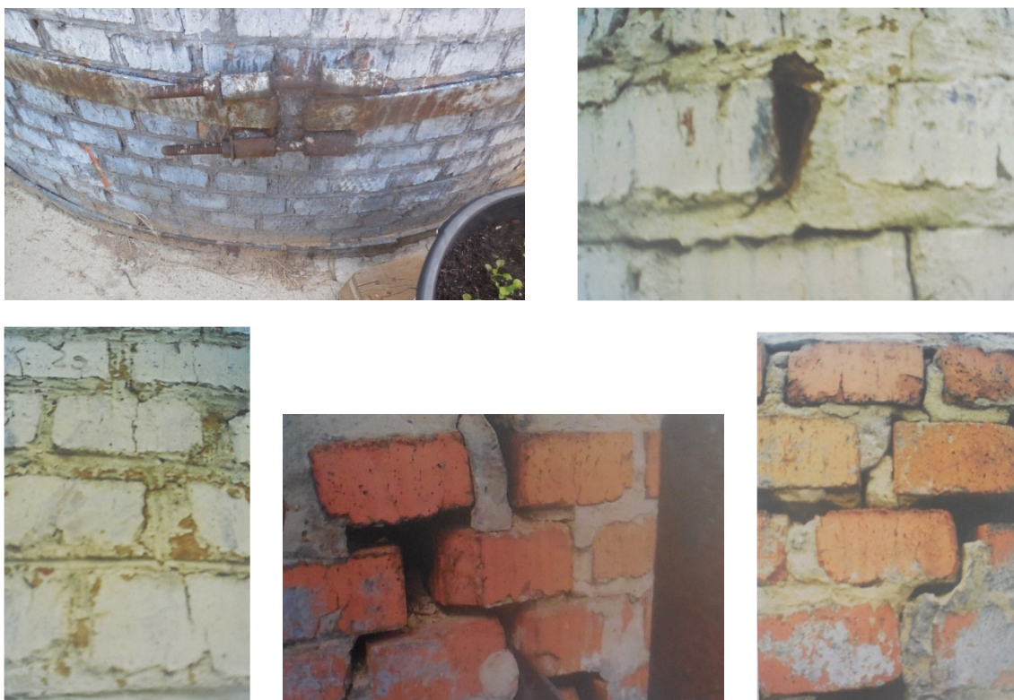
Рис. 2. Дефекты и повреждения наружной поверхности трубы
