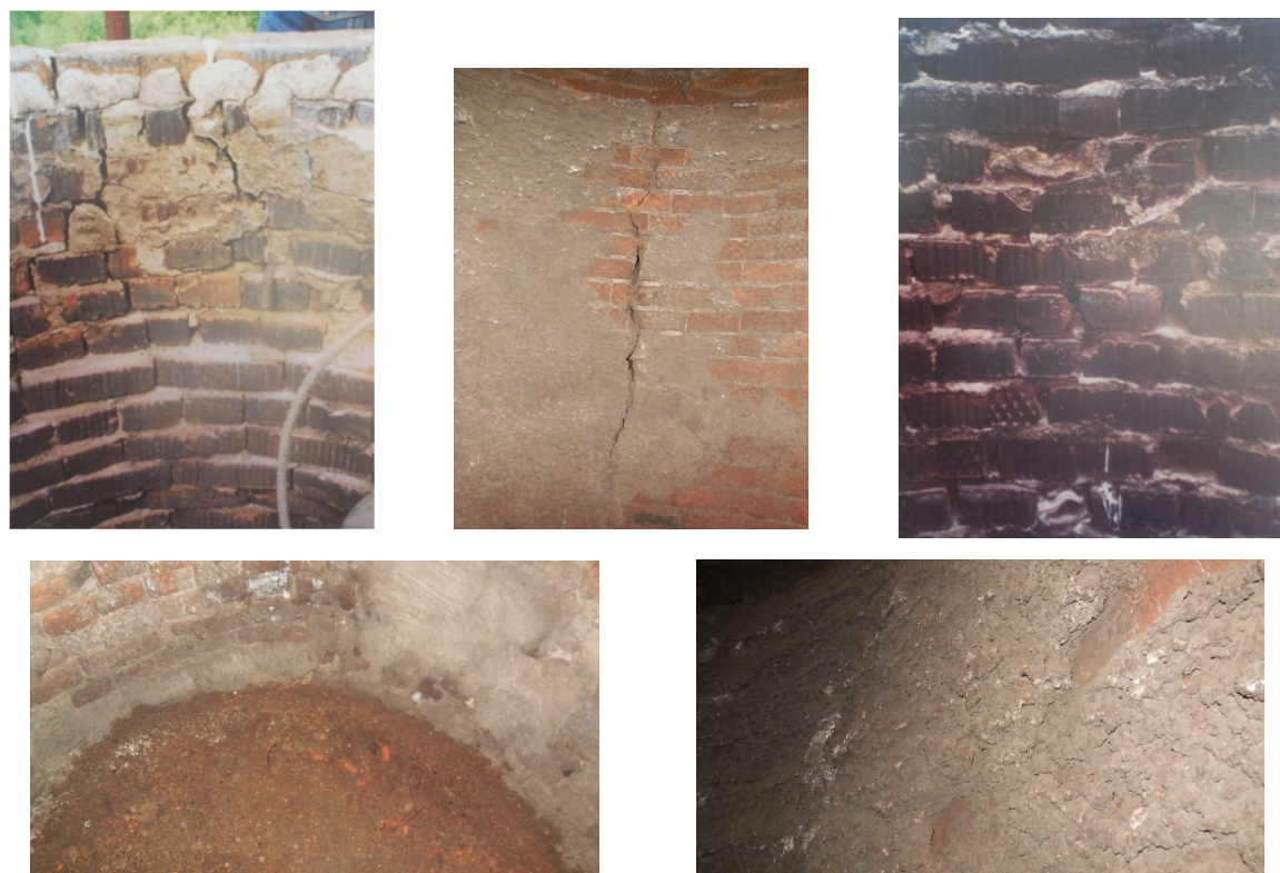
Рис. 3. Дефекты и повреждения внутренней поверхности трубы
