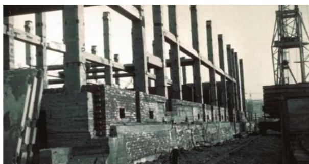
Рис. 6. Часть строящегося здания АБК на поверхностном фундаменте-оболочке в г. Норильск [Источник: https://kurl.ru/yQdKX ]
