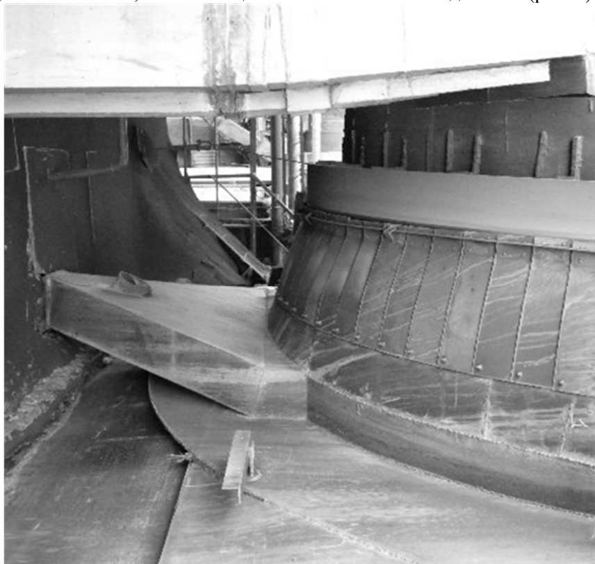
Рис. 8. Установленное на предприятии уплотнительное устройство
