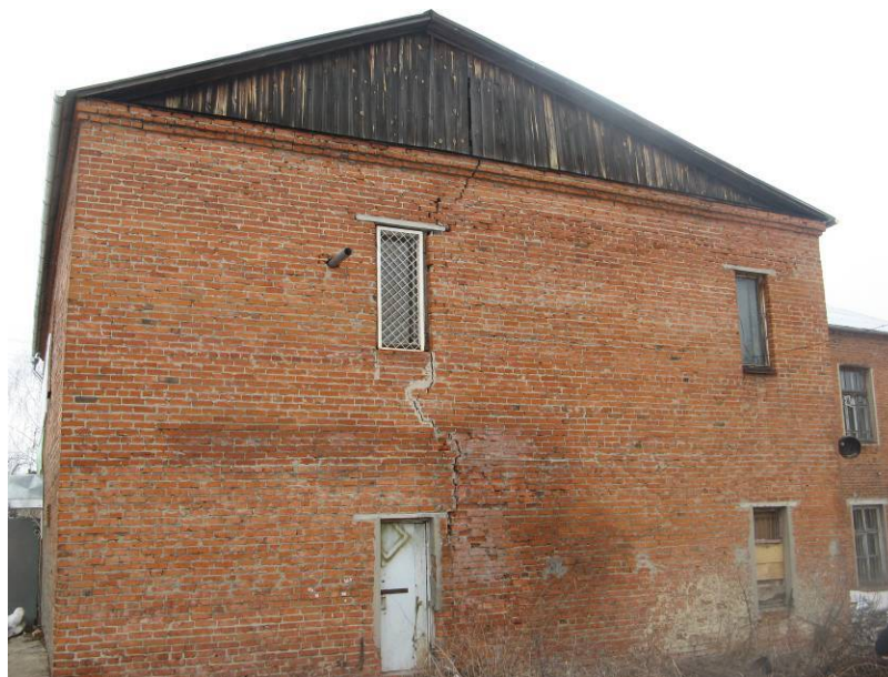
Рис. 1. Вертикальная сквозная трещина в кирпичной кладке в ослабленном сечении стены в зоне расположения оконных проемов
