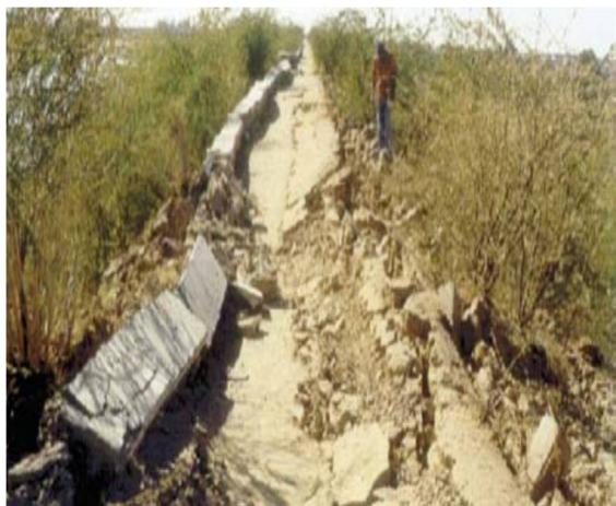
Рис. 4. Продольные трещины на верховой грани плотины Фейтигадх (Индия), вызванные землетрясением Бхудж 26.01.2001г. [2, 3]
