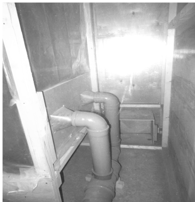
Рис. 3. Экспериментальная лабораторная установка системы пылеудаления при выгрузке сыпучих материалов в приемный бункер (вид слева)
