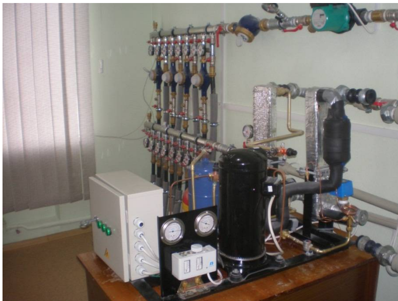
Рис. 1. Наземная часть геотермальной экспериментальной системы УкрГГРИ
