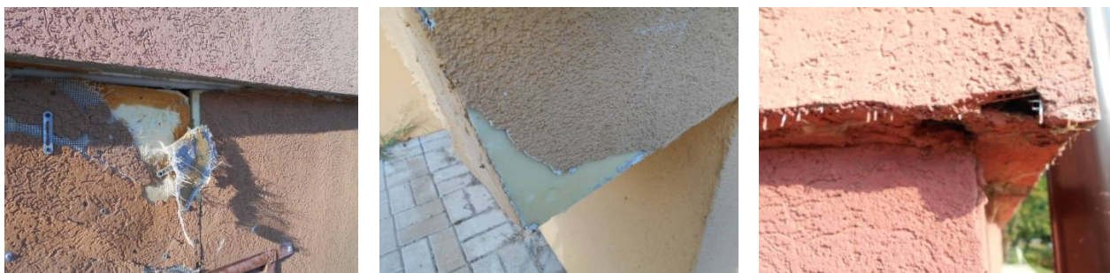
Рис. 1. Дефекты монтажа стеклохолста под штукатурную основу
