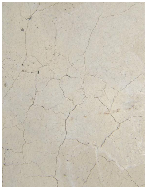
Рис. 1. Сетчатые трещины на поверхности бетонных кубиков, состав №1 через 18 суток твердения в камере нормального твердения
